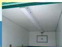
Luftverteilungskanal für die Standheizung
