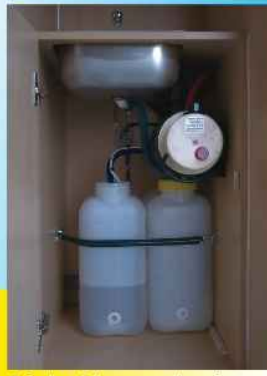
Frisch- Abwasserkanister mit Warmwasserboiler
